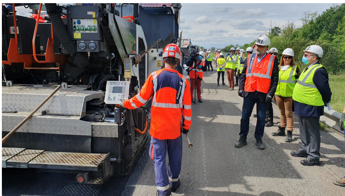
Visite du chantier des autoroutes du sud de la France (ASF) sur l'A62 lors de la reprise d'activité économique dans le secteur du BTP le 30 avril 2020
